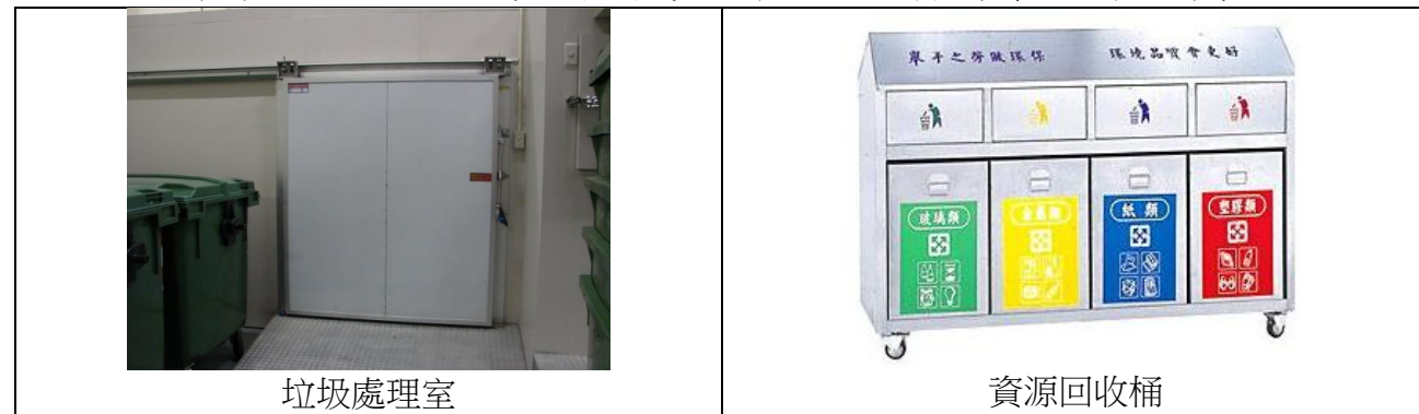
圖 12-16 設置冷藏、冷凍或壓縮等垃圾前置處理設備
